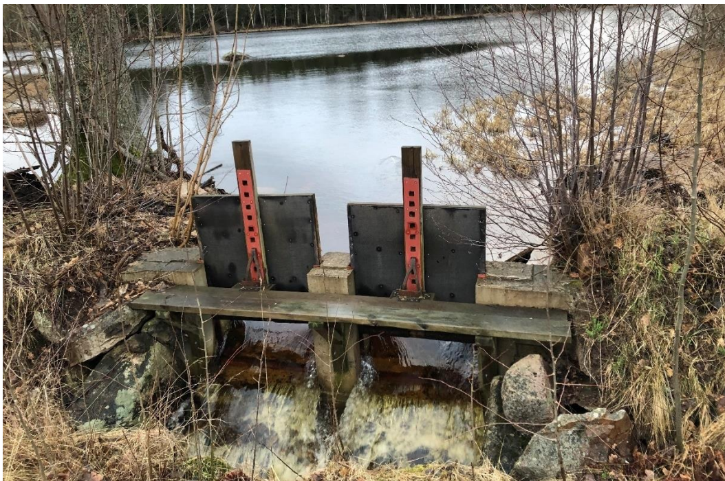
Figur 12. Regleringsanordning i Västra utloppet (Sweco, 2020).
