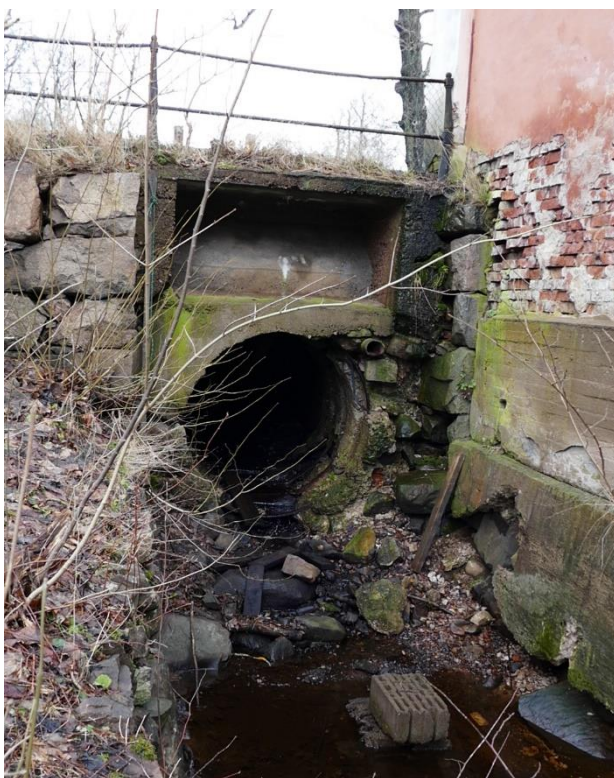
Figur 8. Dämmets vänstra utskovsparti sett från nedströmssidan. Här har det tidigare funnit en tub till det nedlagda vattenkraftverket. Foto Sweco, 2018
